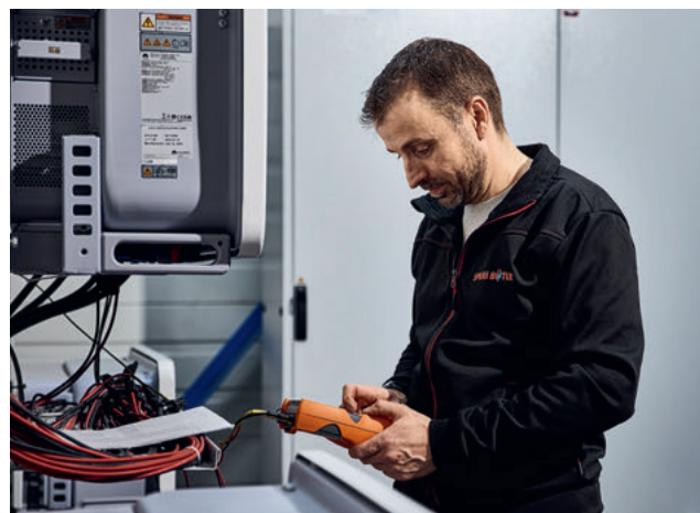
Configuration des onduleurs par l'installateur-électricien de Speri & Bütler AG
