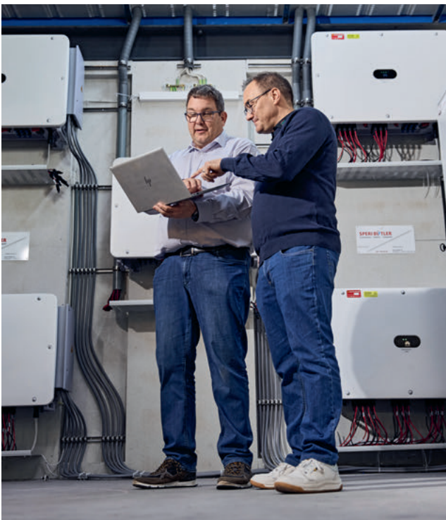
Cinque invertitori Huawei convertono 733 kWp in tensione di rete AC.
